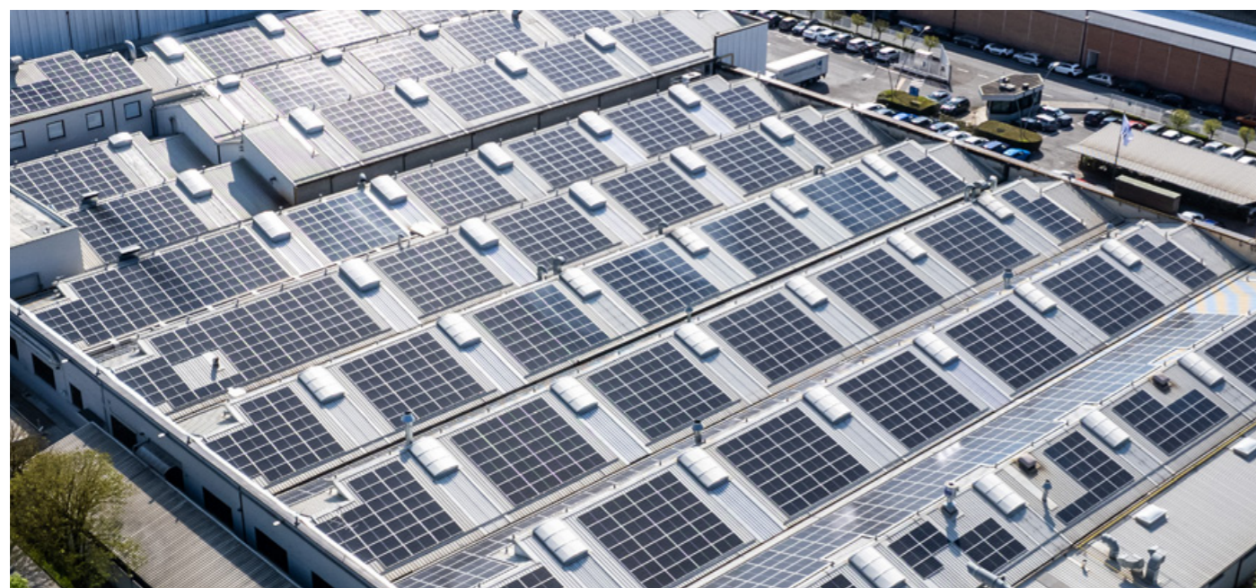
Dettaglio dell'impianto fotovoltaico dello stabilimento Sede (Suzzara, 2023)
